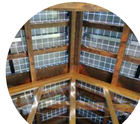
2024 / Terrasse GS-Module / 8,52 kWp
