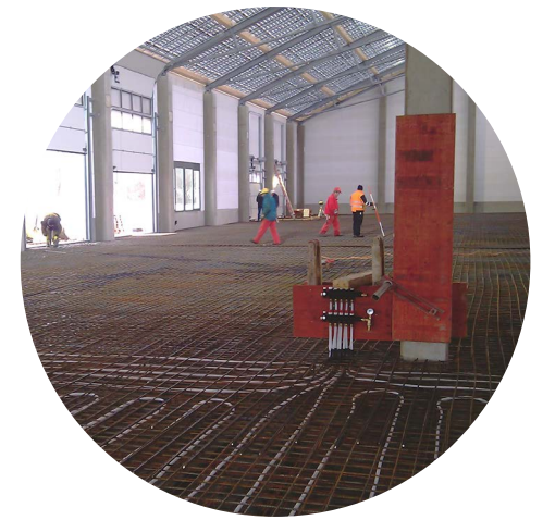
Sichtbare Betonkernaktivierung im Baustatus
